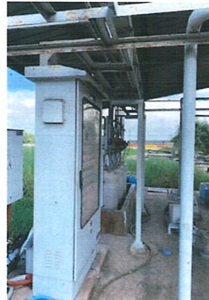
Khu vực tủ điện và các bồn hóa chất
