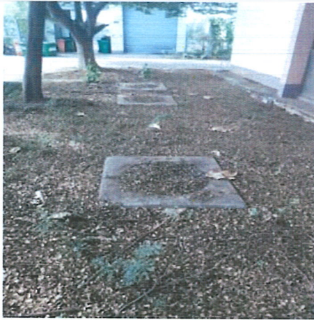
Bể tự hoại 3 ngăn khu vực văn phòng nhà điều hành
